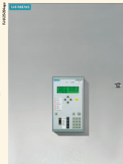
Низковольтный шкаф с многофункциональной защитой SIPROTEC 4 7SJ61 (пример)
