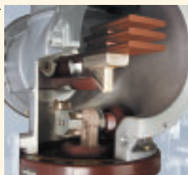
Фидер подготовл. к ЗАЗЕМЛЕНИЮ
