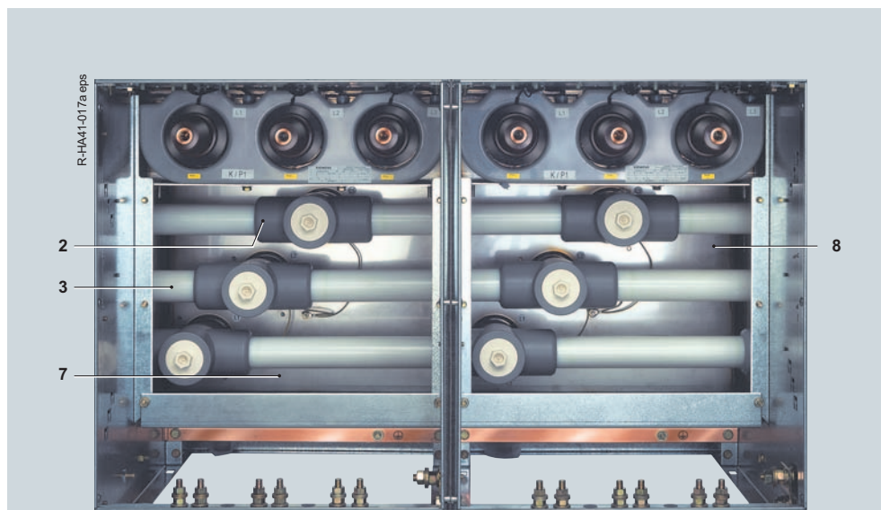
Отсеки сборных шин над 2 ячейками с соединениями сборных шин, со снятой крышкой
