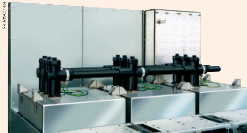
Сборные шины 1250 А, втычные, полностью заизолированные (вид спереди трех ячеек, без низковольтных шкафов)
