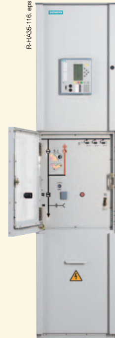
Механическая панель управления при открытой дверце ячейки КРУЭ
