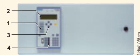
На ячейке силового выключателя типа LS1 для дополнительного низковольтного оборудования
